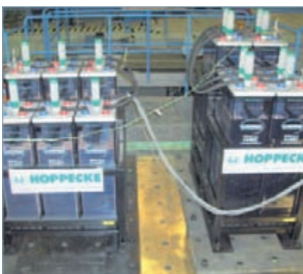
HOPPECKE OSPHC Zellen mit AquaGen® beim seismischen Test. HOPPECKE OSPHC cells with AquaGen® in seismic testing.
