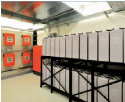
Solarbatterien der neuesten Technologie im Einsatz.
