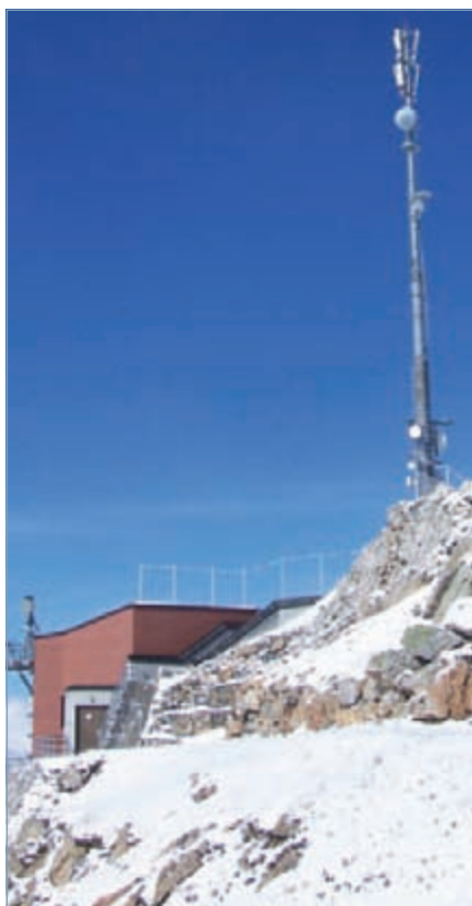
GSM und UMTS Mobilfunkstationen. GSM and UMTS mobile stations.
