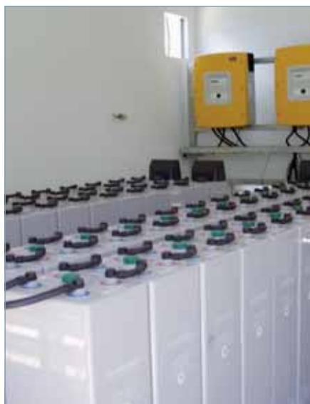
HOPPECKE OPzV solar.power 1700 im Einsatz.
