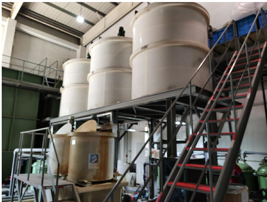
图 4-7 铅酸废水处理站
