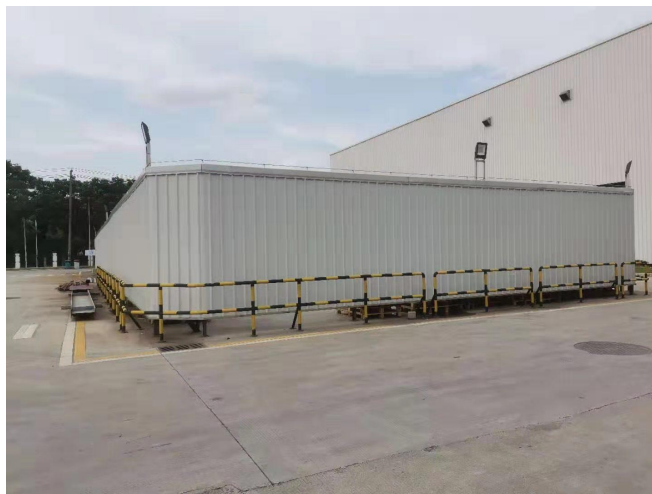
图 4-10 初期雨水池（事故状态下可作应急池使用）
