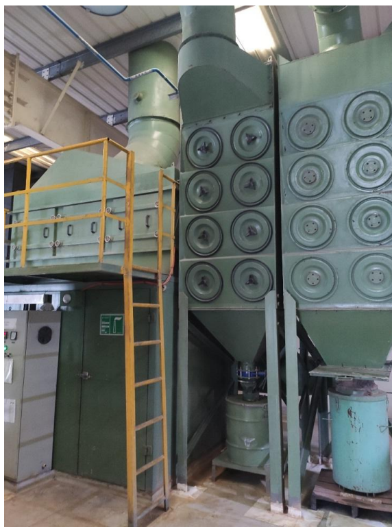
图 4-2 沉流式滤筒除尘器+高效过滤器
