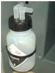
Imagen 7: Separador de condensados sujetado al soporte
