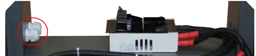
Abbildung 8: Obere Ebene des Trägers mit Kabelverschraubungen
