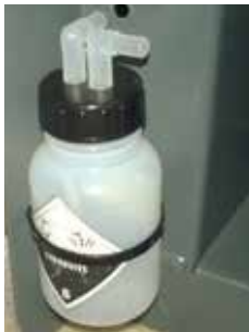
Abbildung 7: Kondensatabscheider befestigt am Träger
