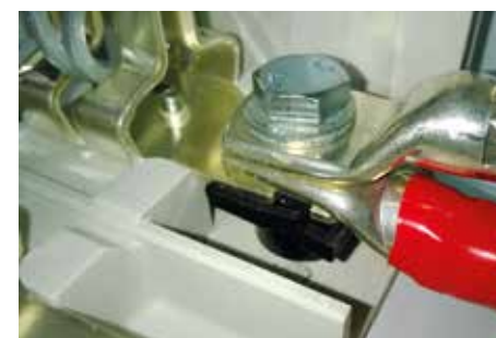
Imagen 5: Terminales de cables rotados entre sí
