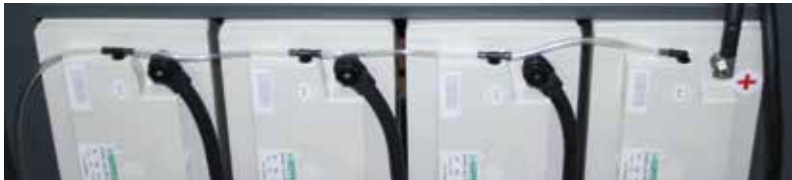
Imagen 6: Ejemplo de desgasificación central
