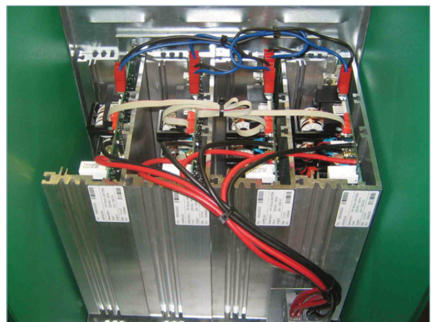
Podłączone równolegle moduły prostownika, urządzenie otwarte
